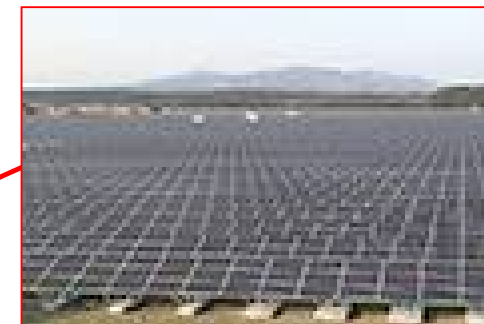
ユーラス六ヶ所ソーラーパーク (青森県六ヶ所村) / 115MW
