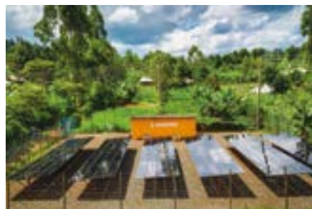
在肯尼亚无电地区搭建的微电网
