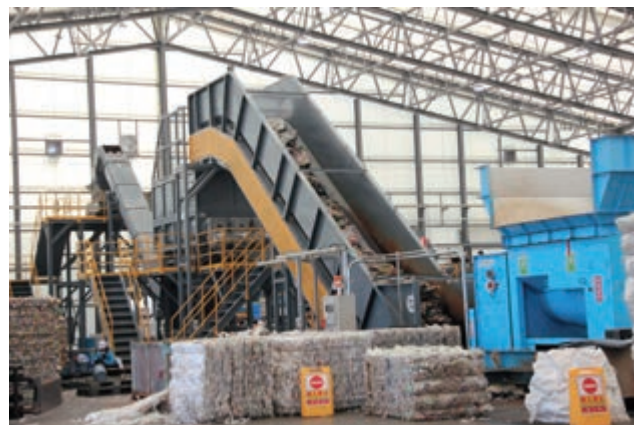
豊通ペトリサイクルシステムズ工場内部
